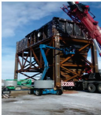
610D-2003 Pumpbox Test Fit. 22-Jan-15
