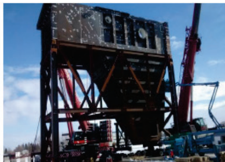
610D-2003 Pumpbox Test Fit. 22-Jan-15
