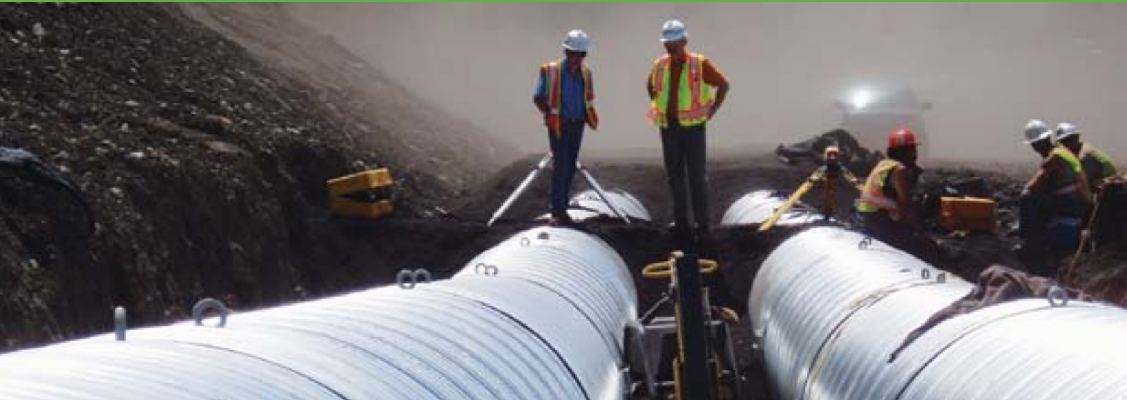
Un desvío de agua en construcción en una de nuestras operaciones de carbón metalúrgico ubicadas en el valle Elk de Columbia Británica.
